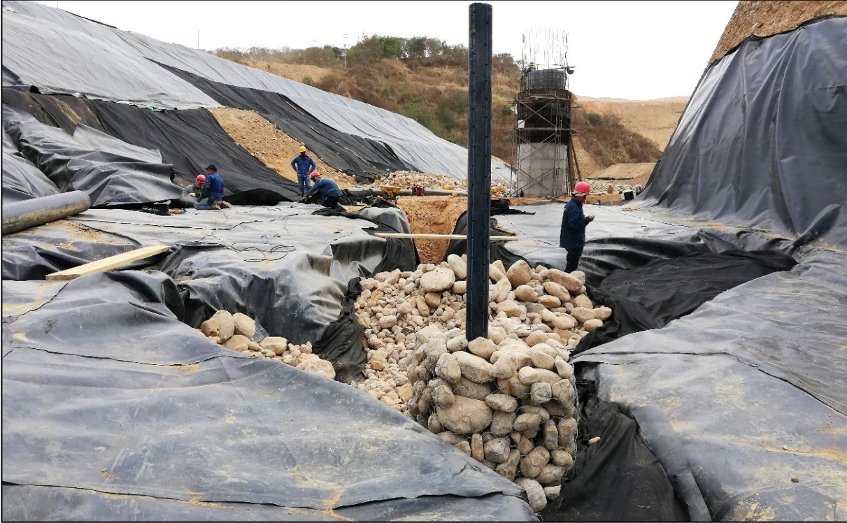
Sistema de Chimenea
